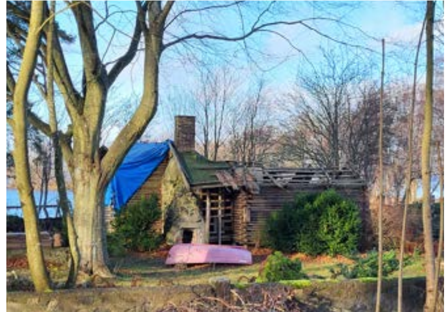
De två sammanbyggda husen som utgjort övernattningsstuga och kök sett från söder, med skorsten och murstock i hörnet. Taken är i dåligt skick.
